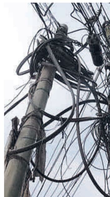
Die Stromversorgung entspricht auch nicht deutschen Standards.
